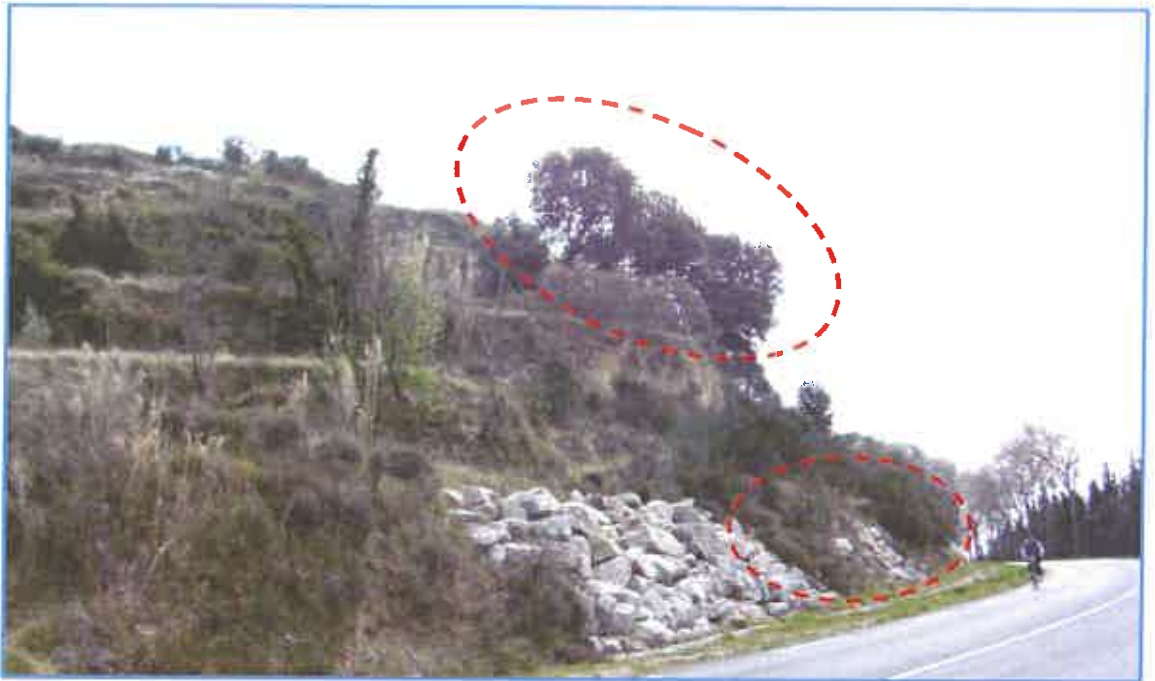
Photographie de l'enrochement, des zones de recouvrement et des arbres basculés.
