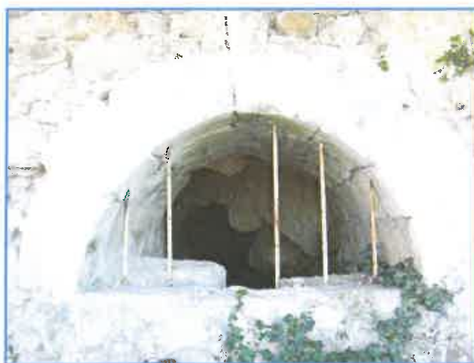
Photographie du captage par galerie drainante de la résurgence au lieu-dit "Les Verdies" au sein de colluvions de pente grossières.
