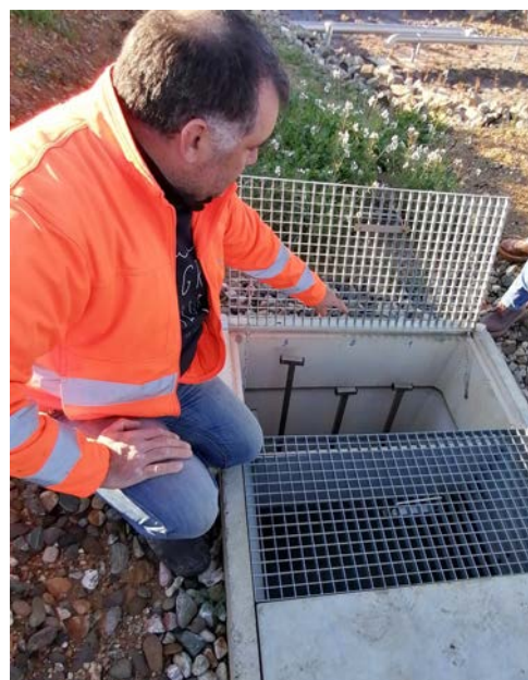
Vérification dégrilleur entrée station à Lagamas
